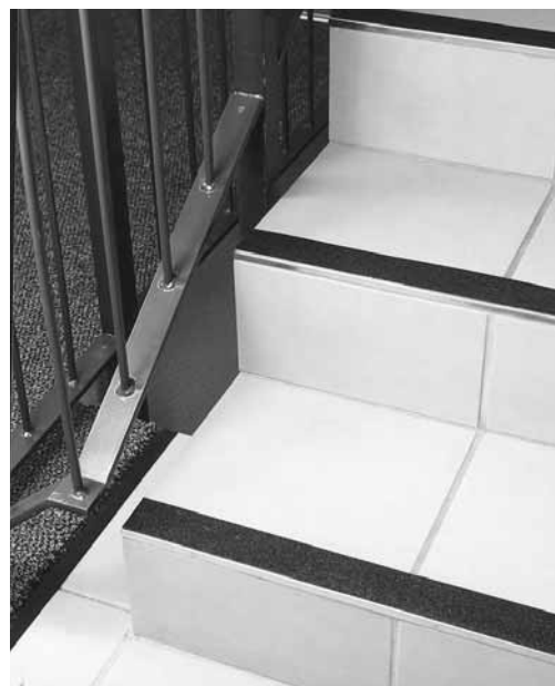
Bild 2: Nachträglich angebrachte Gleitschutzstreifen auf einer glatten Steintreppe.
